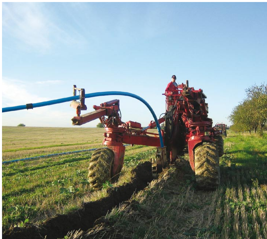
Metoda pluhování umožňuje snížit náklady až na 50 % původních cen. Rychlost pokládky je až 8 km za den.
